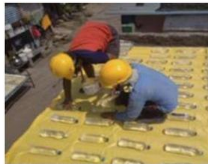
Essai d'un des 11 dispositifs prototypes pour isoler le toit d'habitats informels à Chennai. Photo Fairconditioning.
