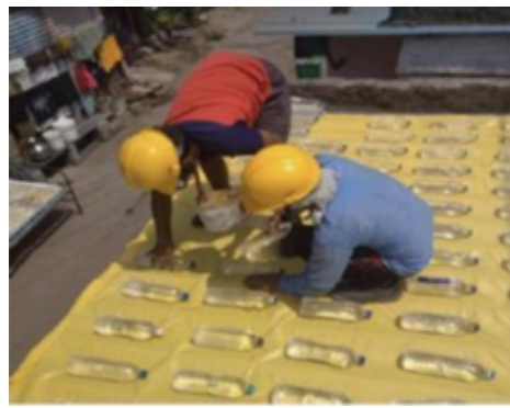
Essai d'un des 11 dispositifs prototypes pour isoler le toit d'habitats informels à Chennai. Photo Fairconditioning.
